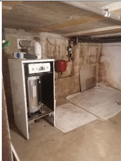
Keller mit Heizungsanlage
