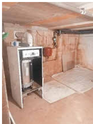
Keller mit Heizungsanlage
