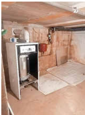
Keller mit Heizungsanlage
